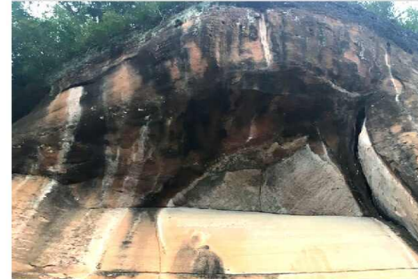
裂隙病害类型的保护措施
